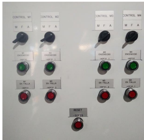
Figura 8.1.0 vista de pulsador reset en el panel de control.
